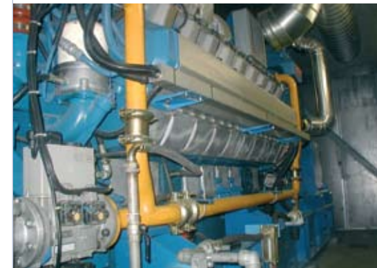
Das Kraft-Wärme-Kopplungswerk in Ispra.
