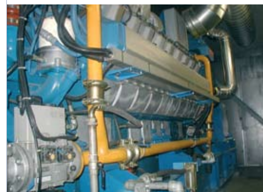
Warmtekrachtfaciliteit in Ispra.
